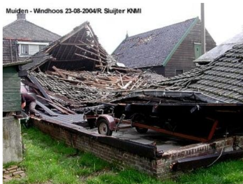
Figuur 3.5: Foto van een door de windhoos getroffen schuur in Muiden (foto van R. Sluijter).
